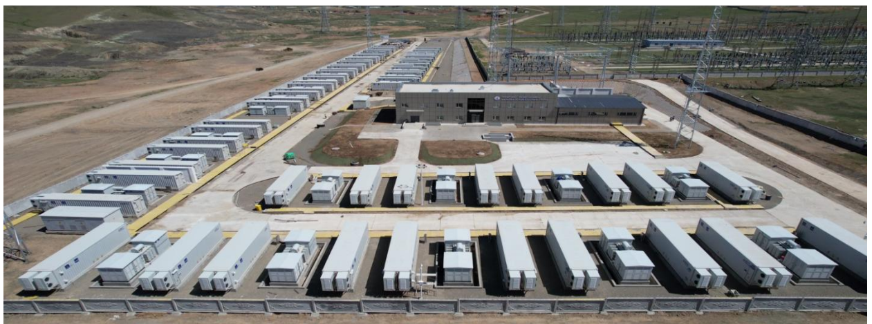
Зураг 32. 80МВт/200МВт.ц Сонгино батарей хуримтлуурын станц.
